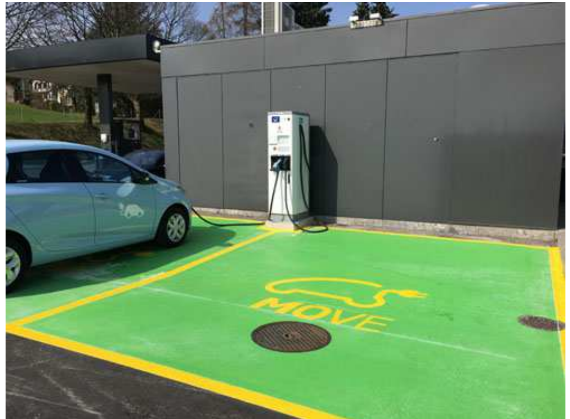
Exemple de réalisation Station de recharge ultrarapide sur l'aire de repos d'Herrlisberg Sud
